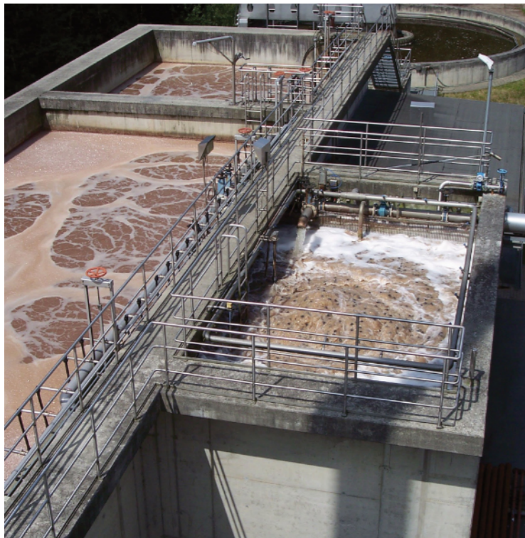
Biologische Abwasserbehandlung, Belebungsbecken
